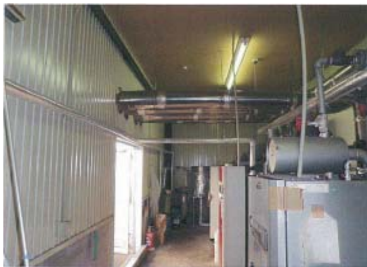
(2) ボイラー室の写真
