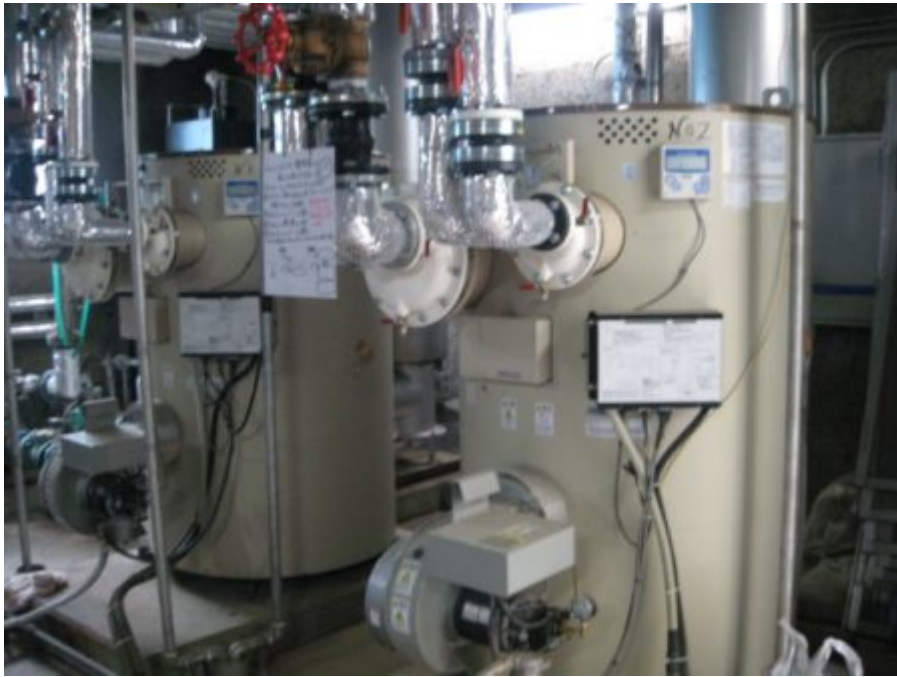
図1 実施前設備（灯油ボイラー）
