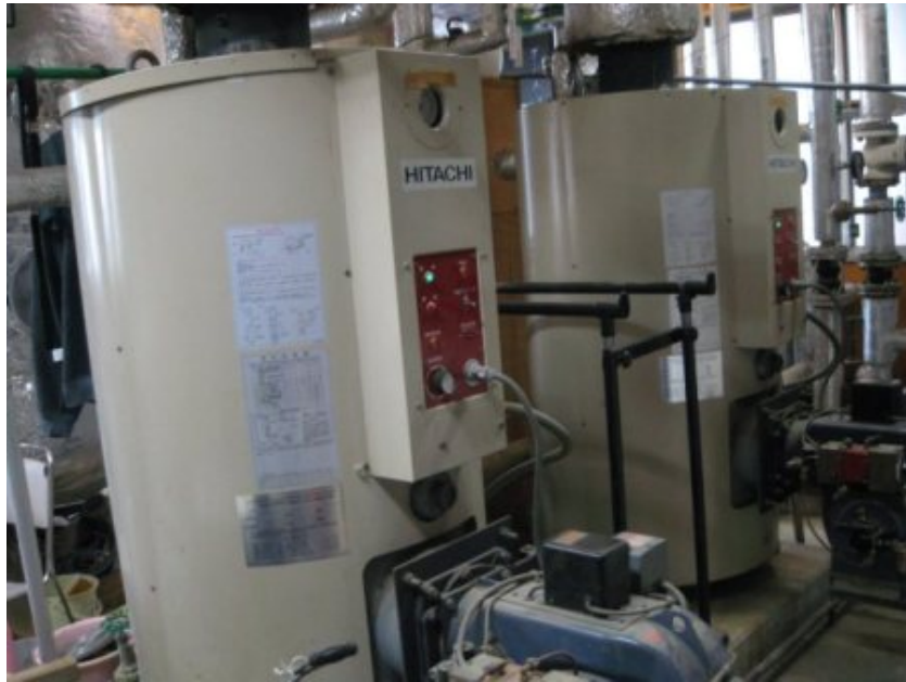
図1 実施前設備（灯油ボイラー）
