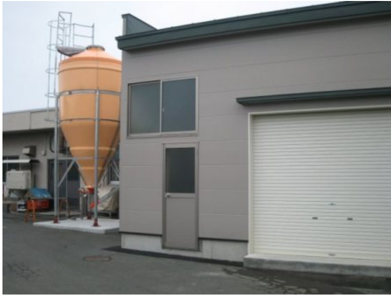
図2 実施後設備 (上: バイオマスボイラー 下: サイロとボイラー設置場所)
