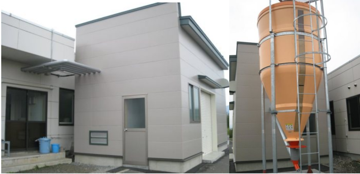
図2 実施後設備 (上: バイオマスボイラー 左下: ボイラー設置場所 右下: サイロ)
