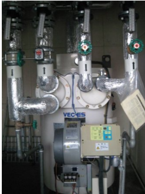
図1 実施前設備（灯油ボイラー）
