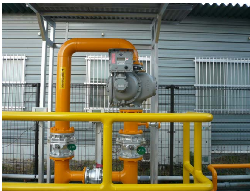
ボイラー用ガスメータ
