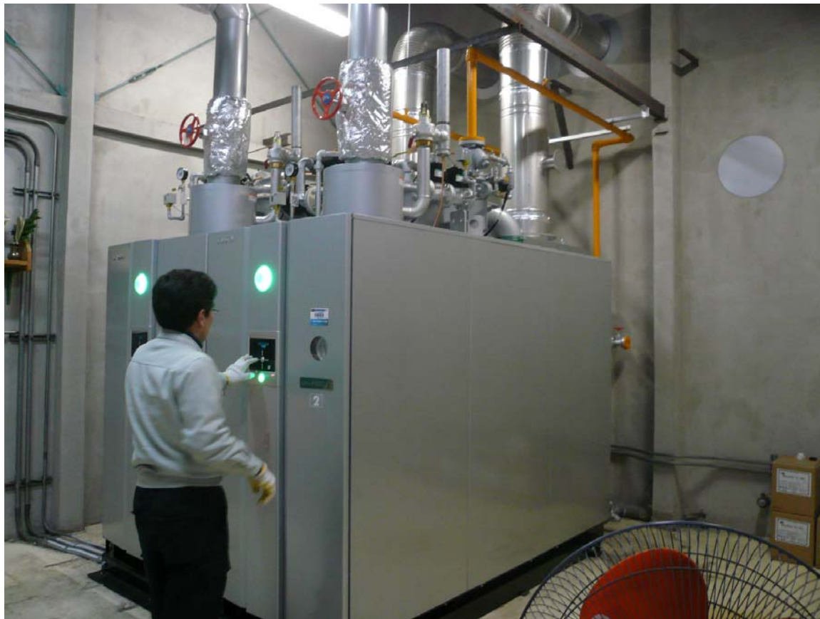
更新ボイラー（平成 24 年 1 月 17 日撮影）
