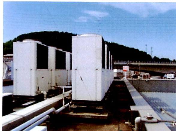
■プロジェクト実施前の圧縮機の写真
