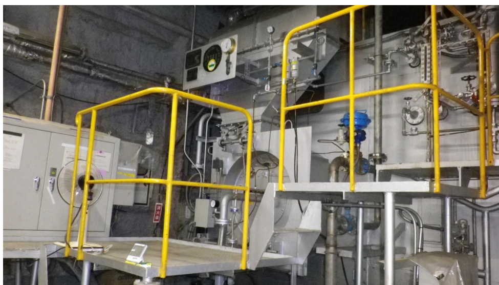
(水管ボイラー)
