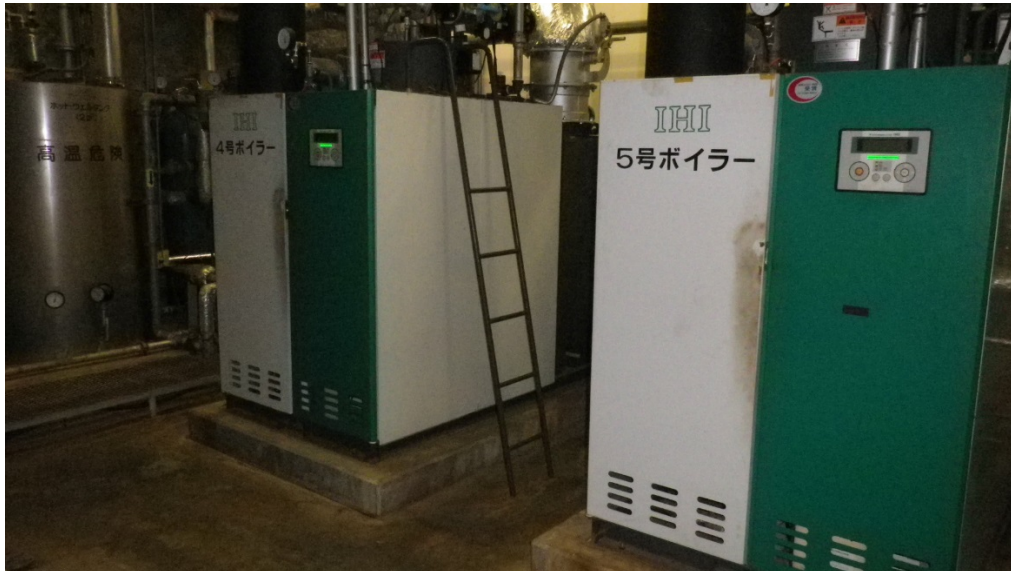
(貫流ボイラー)
