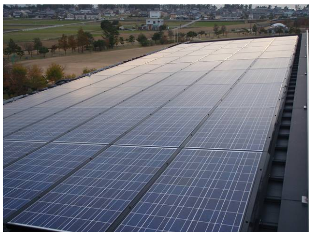
太陽光発電設備
