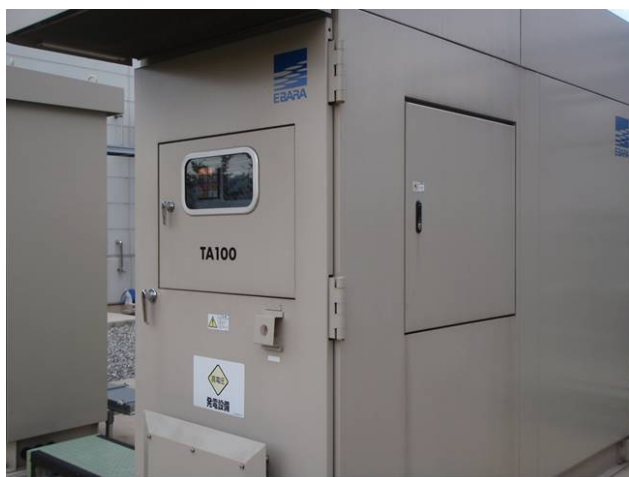
自家用バイオマス発電機
