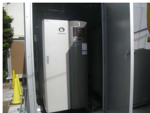
更新後ボイラー
