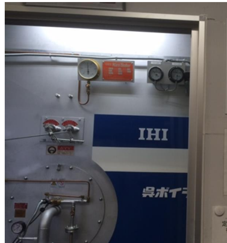
今回設置のボイラー（IHI KMS-10AE） 〔ボイラー室内に設置〕
