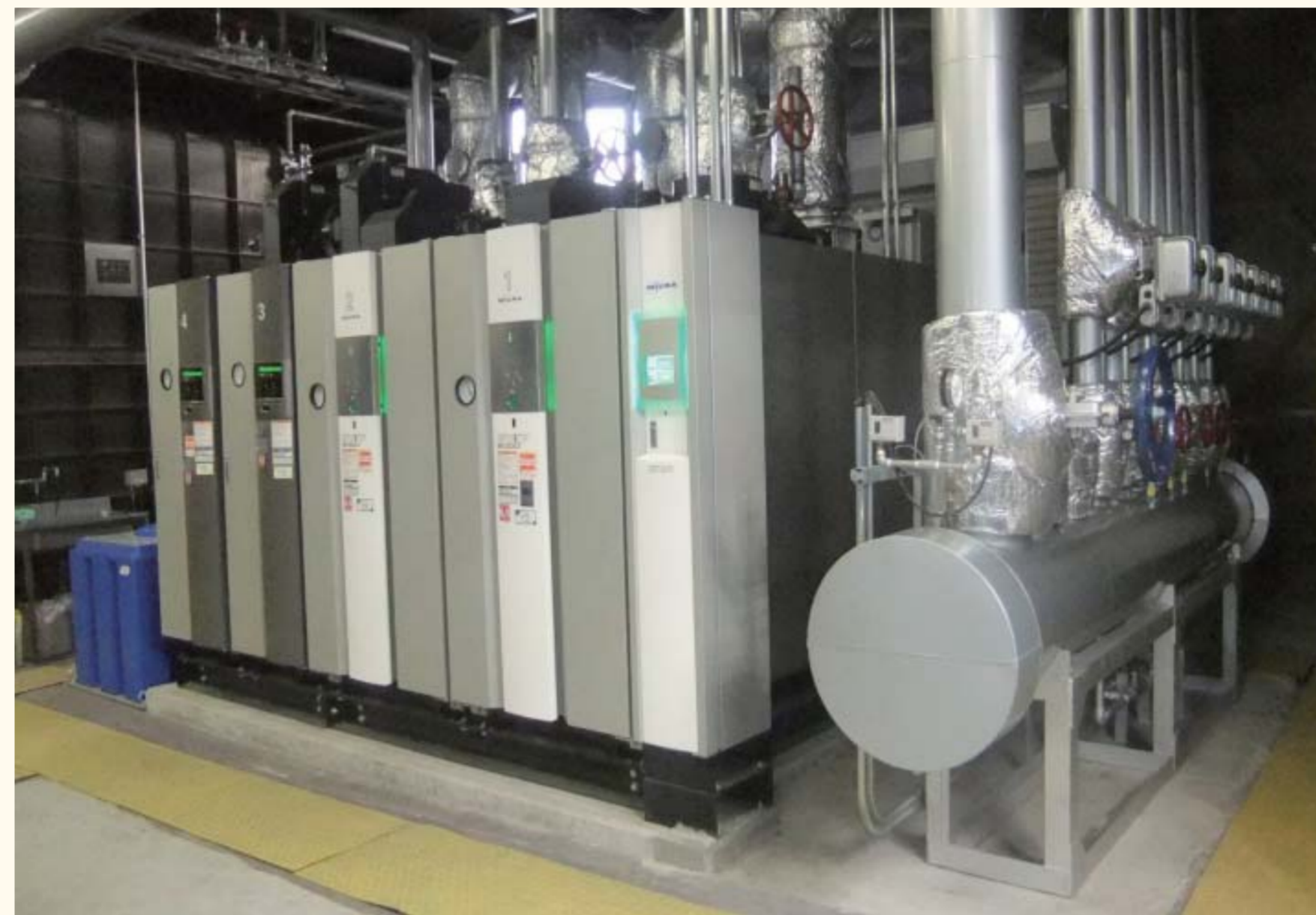
高効率都市ガスボイラー
