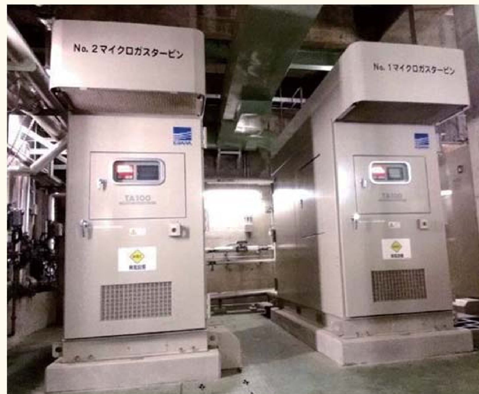
メタンガス発電設備 95kW × 2台
