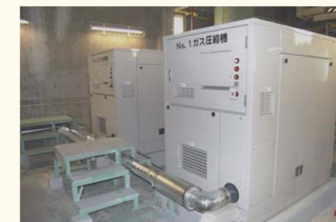
メタンガス圧縮機 2台
