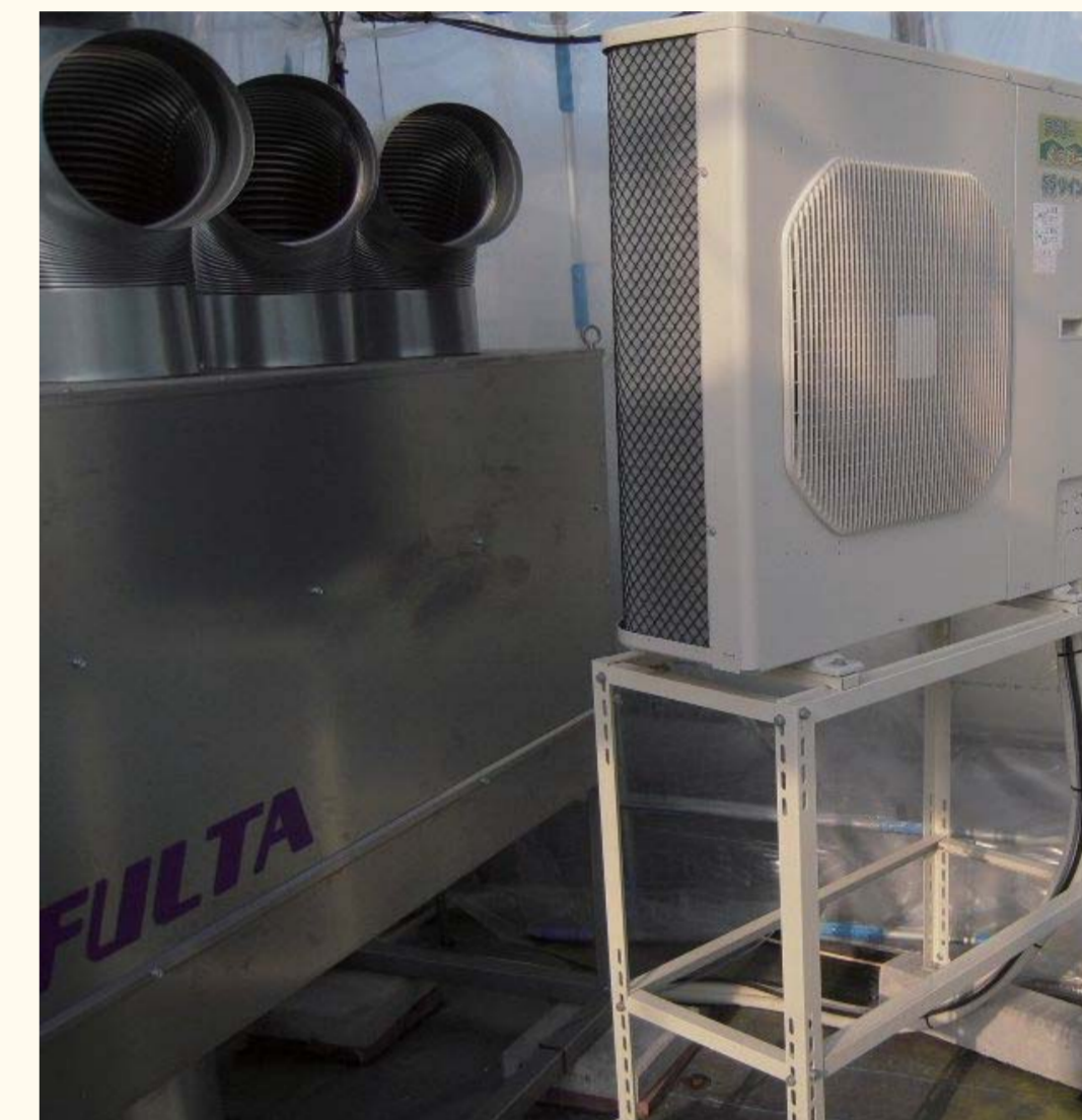
ヒートポンプと灯油焚温風暖房機
