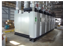
更新したLNG焚ボイラー5基
