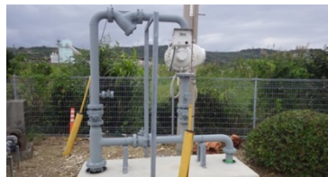
弊社敷地内にあるLNGガスメーター
